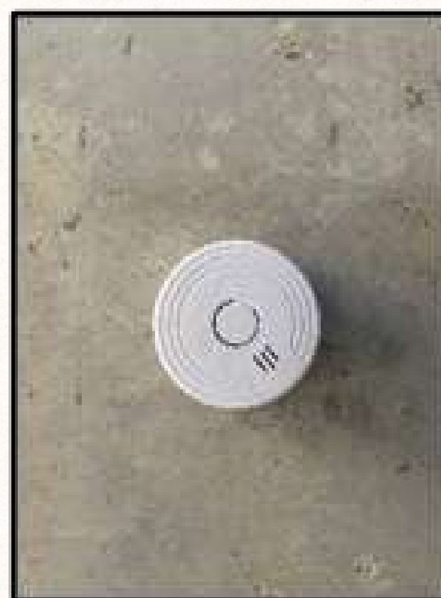
Ilustración 9 - Detector de humo instalado en los apartamentos
