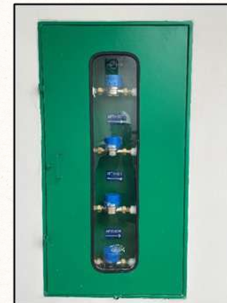
Ilustración 5 - Caja de medidores
