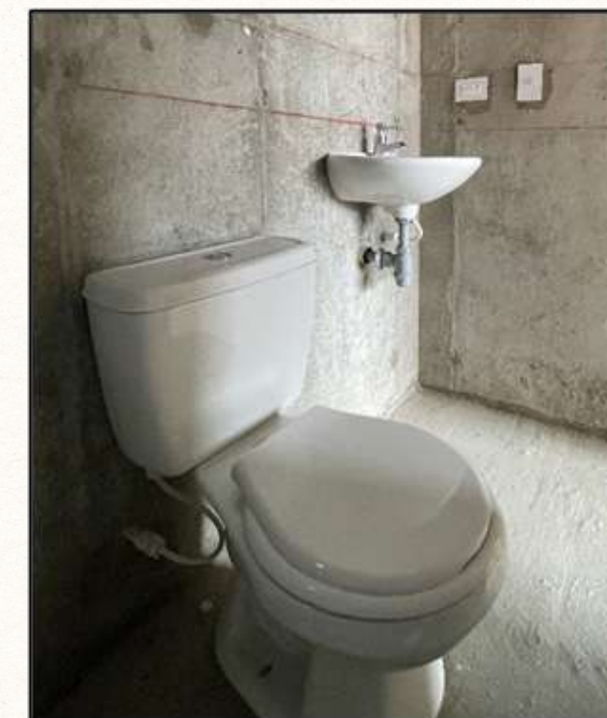
Ilustración 24 - Sanitario Baño social
