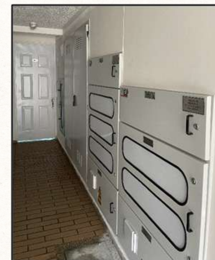
Ilustración 10 - Armario de medidores
