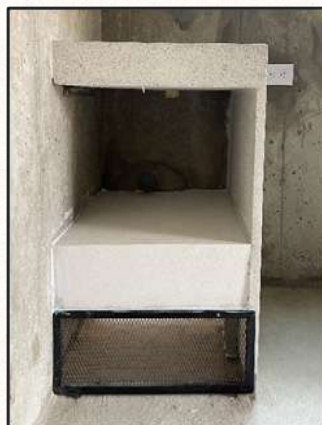
Ilustración 23 - Rejillas de Ventilación
