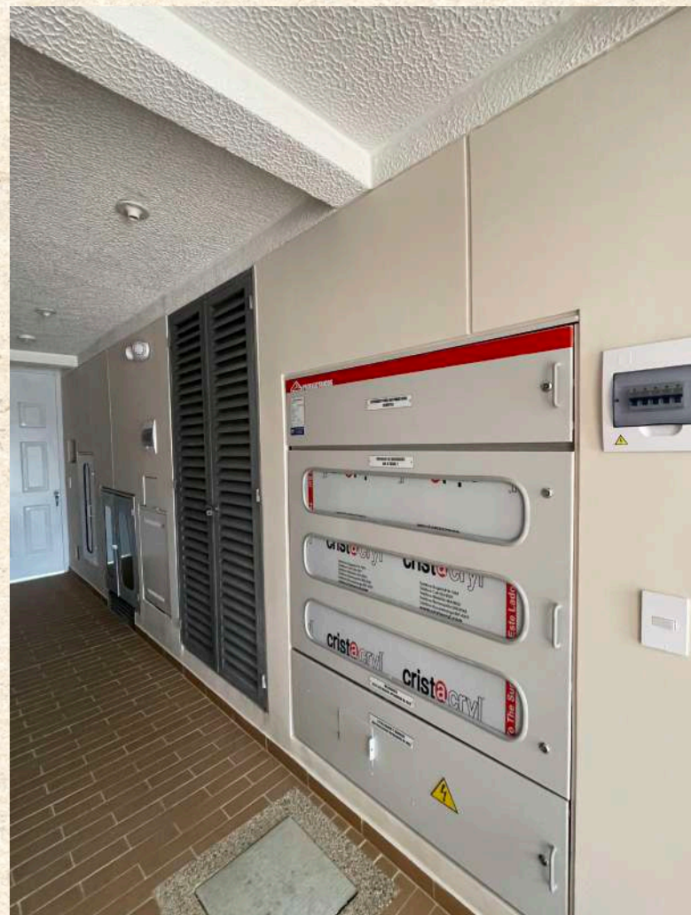
Imagen 13. Armario de medidores de energía
