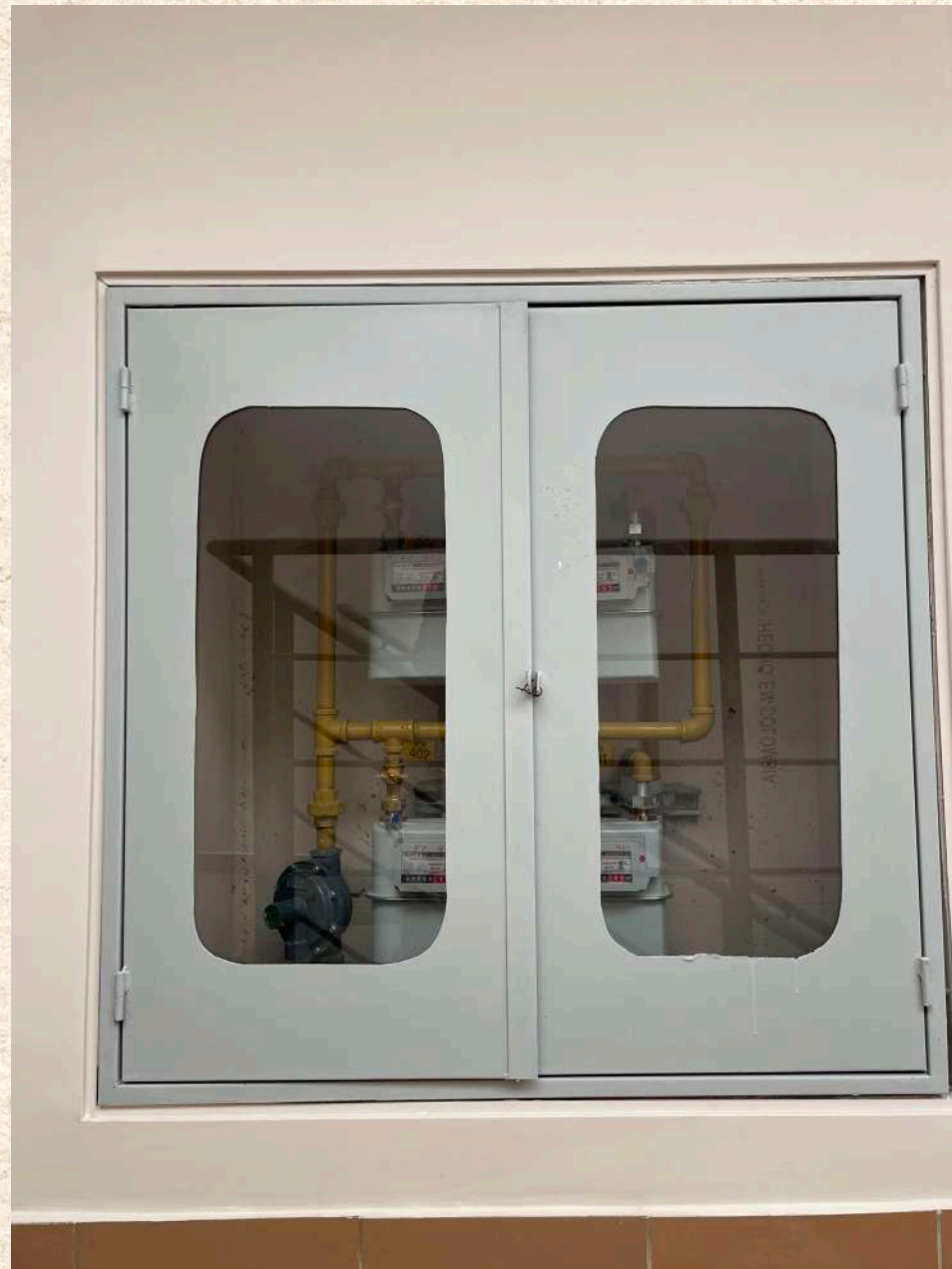
Imagen 12. Gabinete de Medidores Gas
