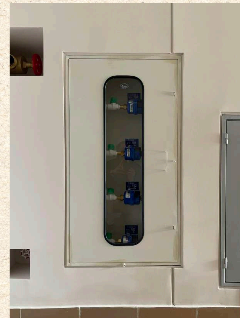
Imagen 9. Cajilla de Medidores de Agua
