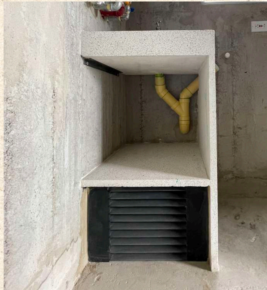
Imagen 23. Rejillas de Ventilación
