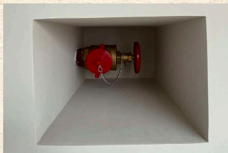
Imagen 10. Válvula Red contra Incendio por piso
