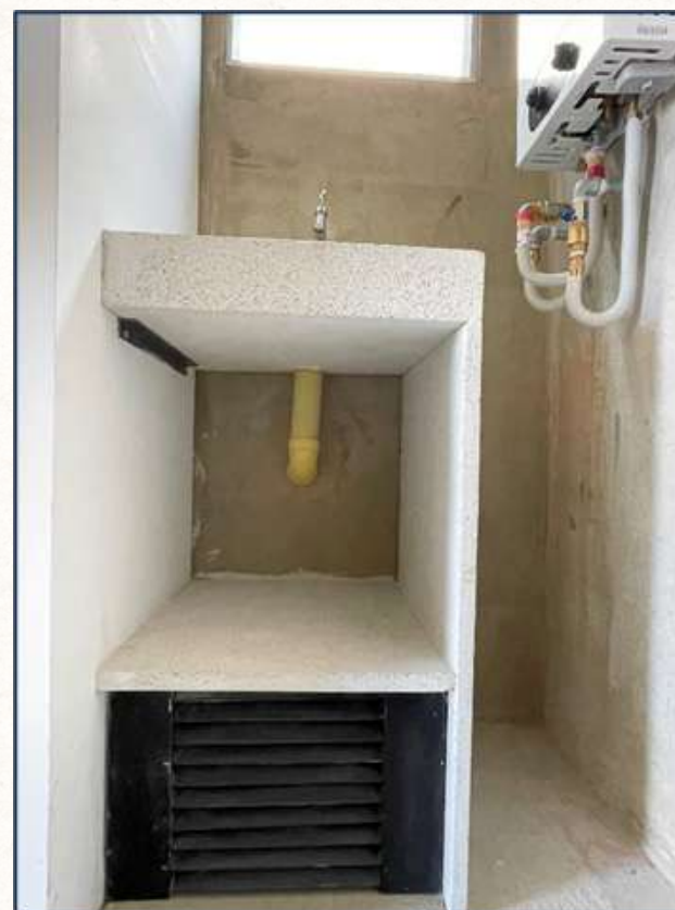
Ilustración 25 - Rejilla de Ventilación
