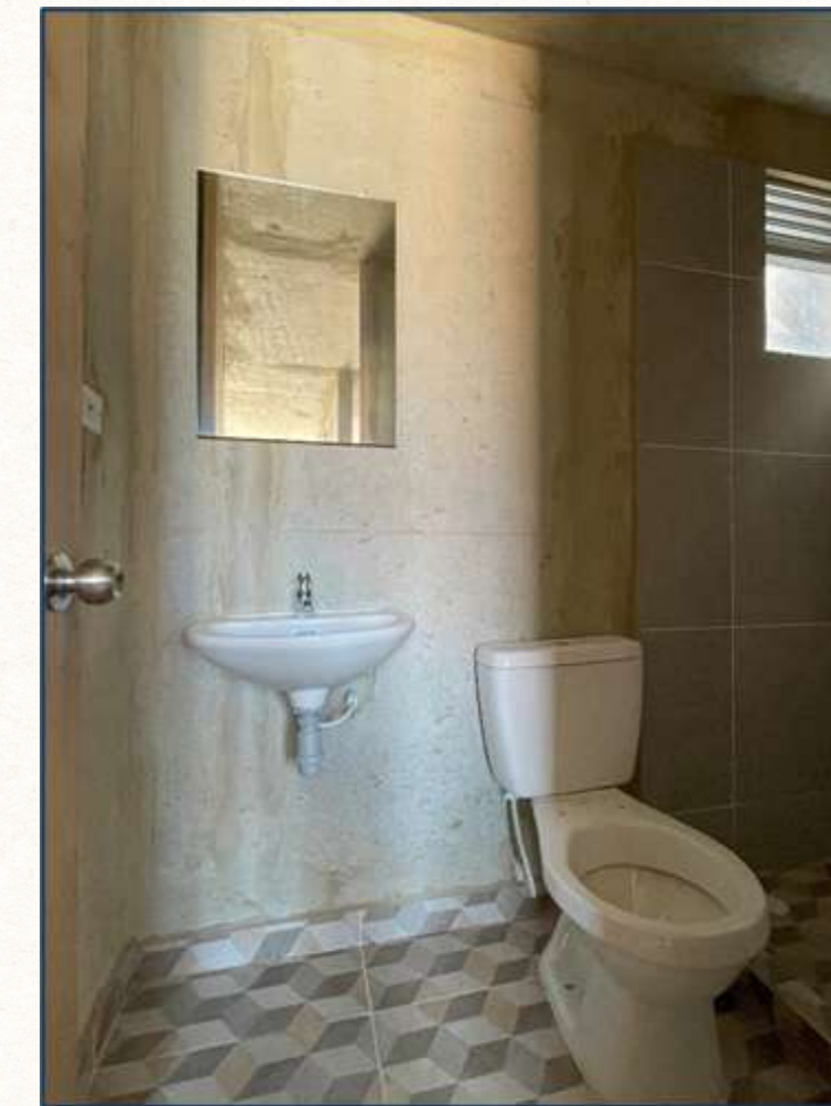
Ilustración 26 - Inodoro y lavamanos
