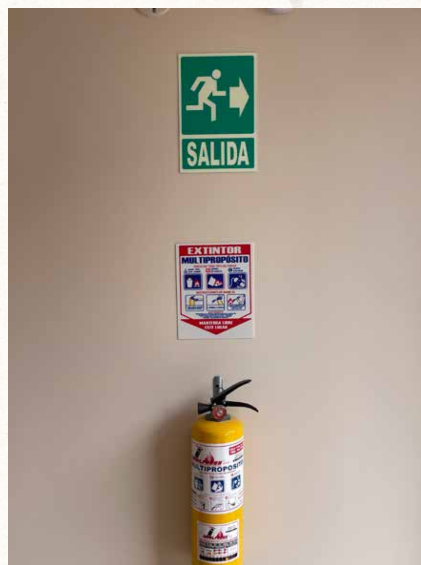
Imagen 11. Extintor portátil en punto fijo
