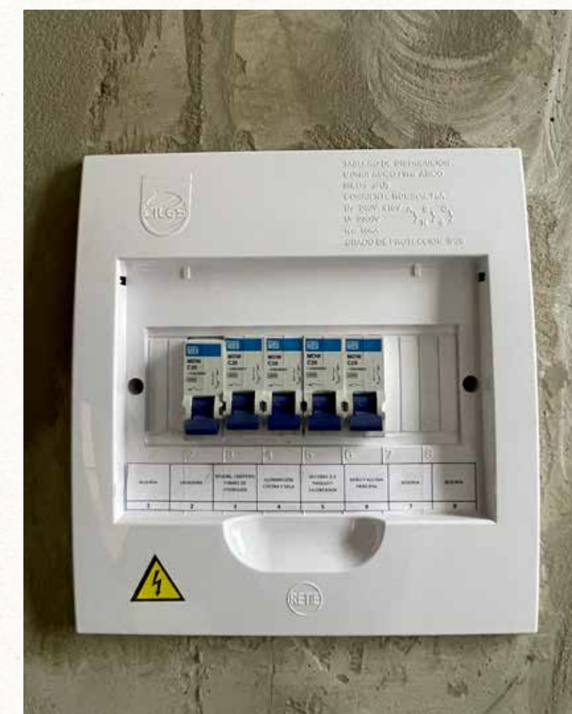
Imagen 15. Tablero circuitos apartamento
