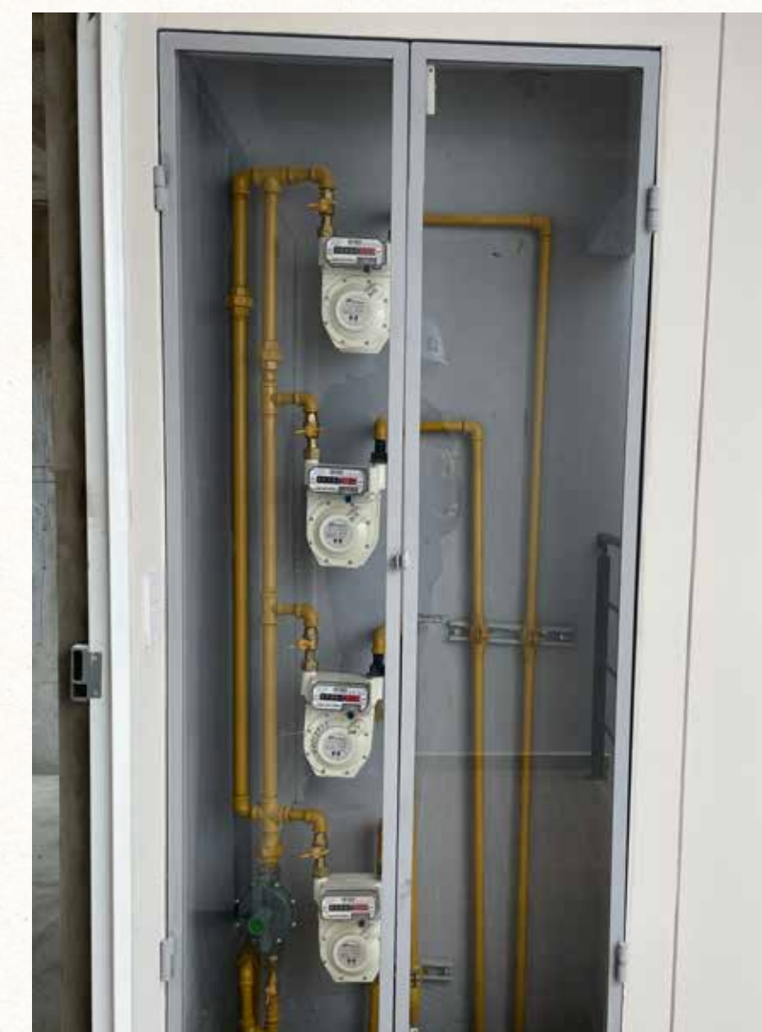
Imagen 14. Nicho medidores de gas
